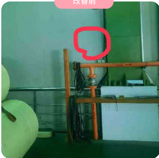
圖示 | 改善前:天然氣開關上方無天然氣偵測器
