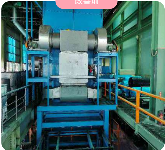
圖示 | 改善前:浸布機過濾拆卸作業區無護欄
